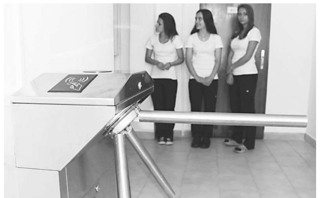
VSTUPNÍ TURNIKETY instalované v rámci projektu Bezpečná škola na karlovarské Střední škole stravování a služeb. Foto Deník/mel
